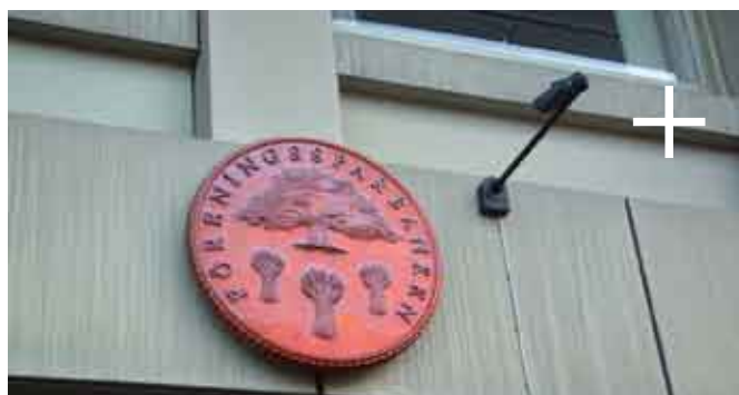
Velafskærmet og enkel skiltebelysning.
