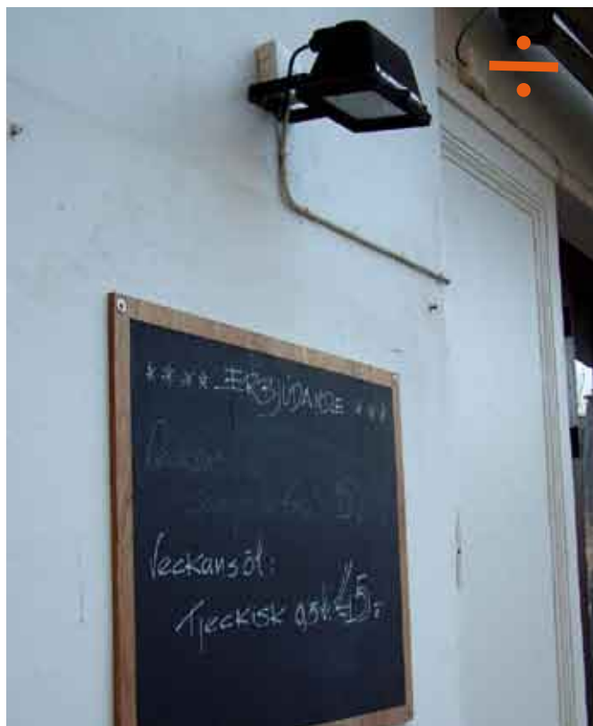
Dårlig tilpasset skiltebelysning.
